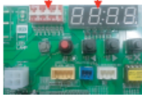
PCB de unidad exterior
