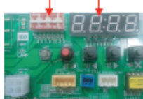
Плата наружного блока
