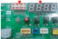
Плата наружного блока
