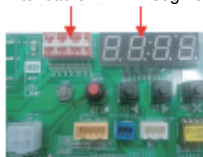
PCB Unità Esterna
