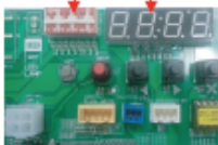
PCB de unidad exterior
